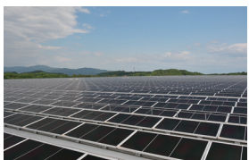
2.6 MW solar array
