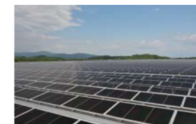
2.6 MW solar array
